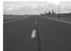
(c) Asfaltın boyuna çatlaması
