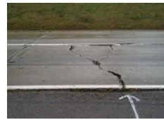
(a) Asfalt kırılması
