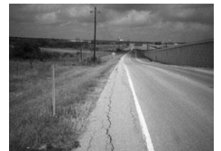
(d) Asfaltın kenar çatlaması
